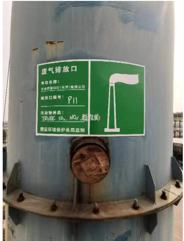
排气筒 P11 采样口及标识牌
