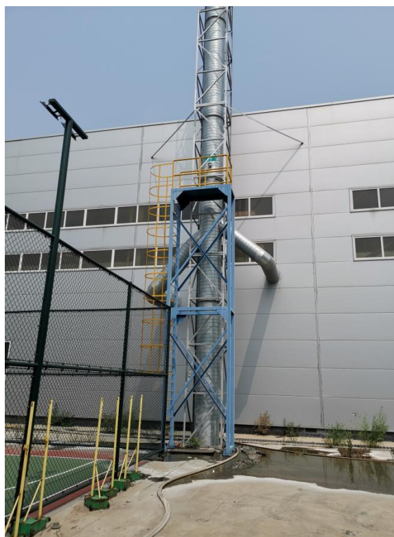
排气筒 P13 及采样平台
