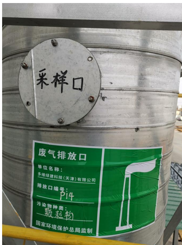
排气筒 P14 采样口及标识牌
