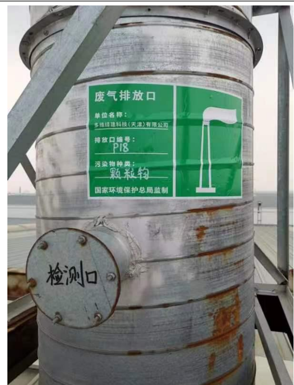
排气筒 P18 采样平台及标识
