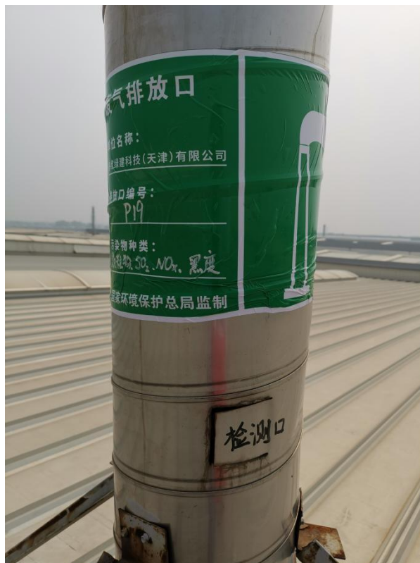
排气筒 P19 采样口
