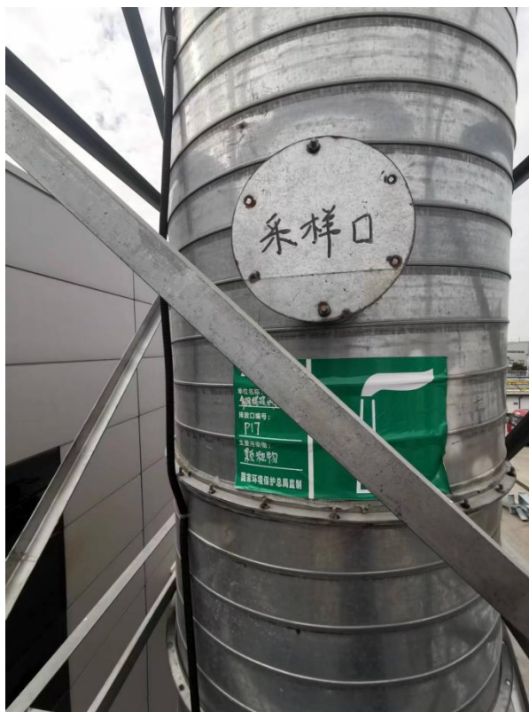
排气筒 P17 采样口及标识牌
