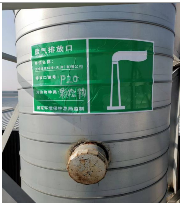
排气筒 P20 采样口
