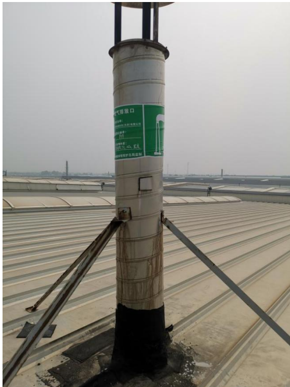
排气筒 P19 采样平台及标识牌
