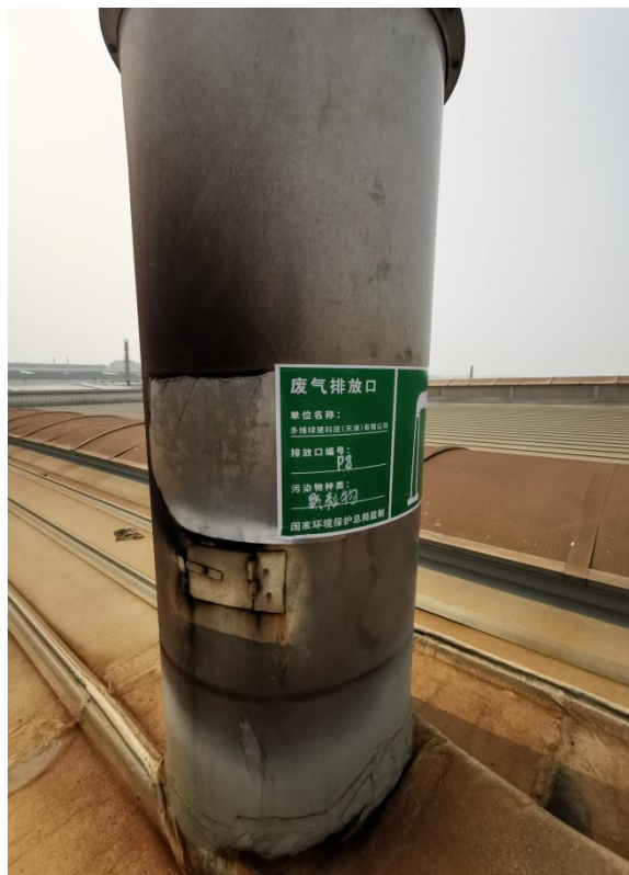
排气筒 P8 采样平台及标识牌
