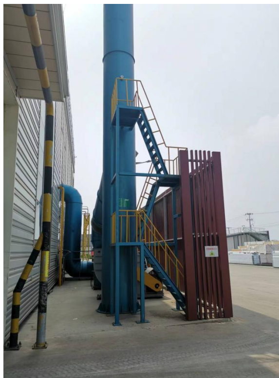
排气筒 P15 采样平台及标识牌
