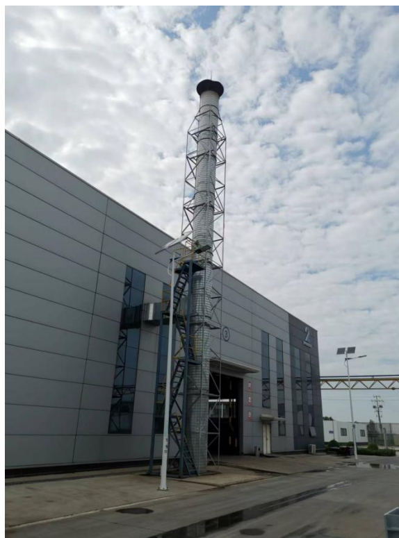
排气筒 P17 及采样平台
