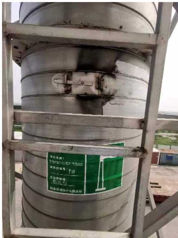
排气筒 P10 采样平台及标识牌
