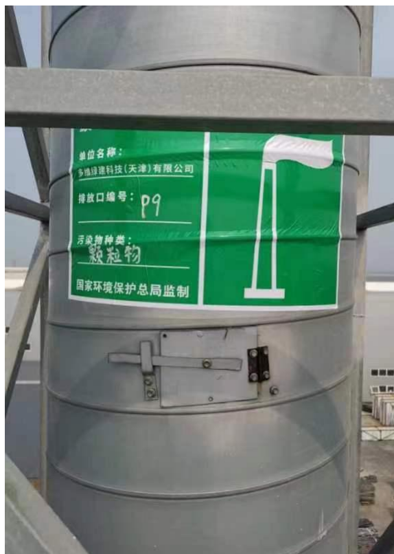
排气筒 P9 采样平台及标识牌
