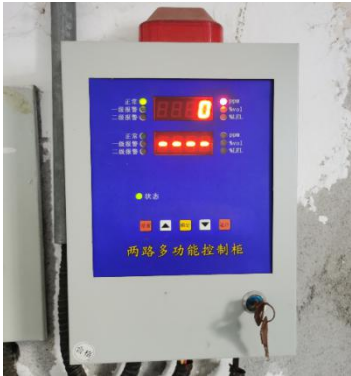
氨泄漏报警装置
