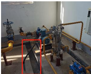
柴油库收集沟槽
