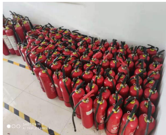
泡沫灭火器（集中存储位置，定期替换）
