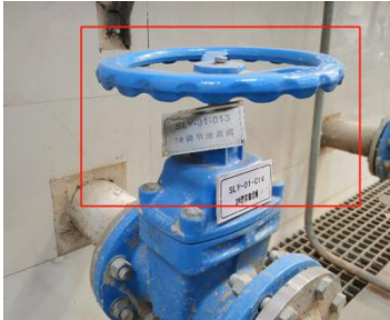
渗滤液处理池泵房手动阀门
