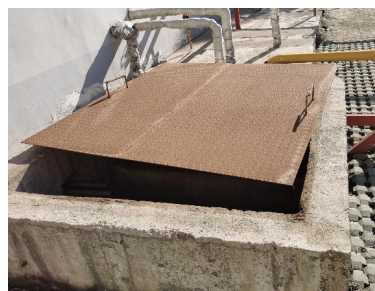
柴油库应急收集池
