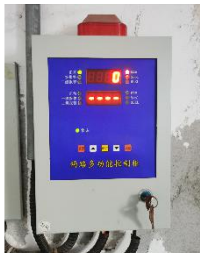
氨泄漏报警装置
