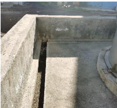
氨水罐区围堰及收集沟槽
