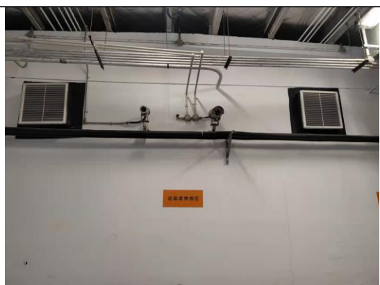
危险暂存间视频监控系统
