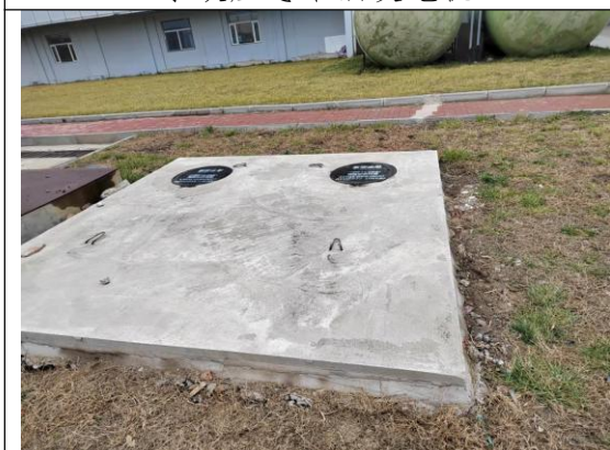
应急水罐的泵壳
