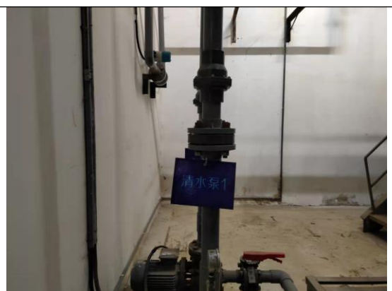
厂区北侧污水处理站清水泵
