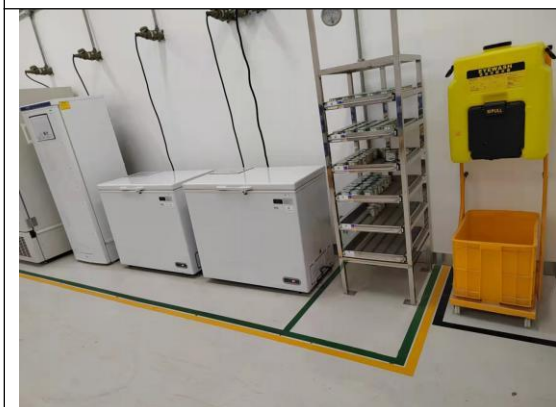
化学品仓库存储锡膏和银浆的冰箱
