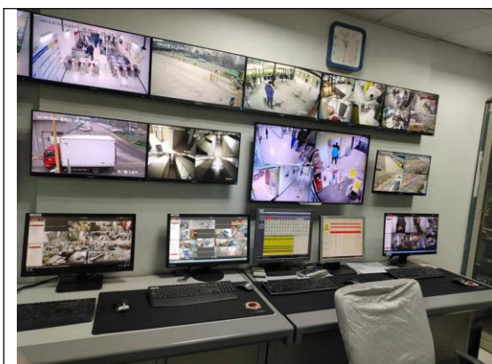
厂区视频监控系统
