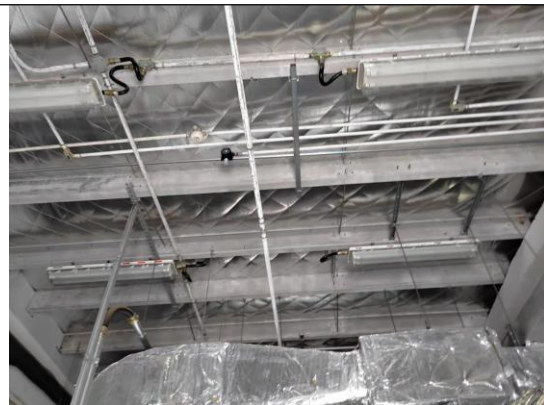
危险化学品仓库烟感及消防水喷淋系统
