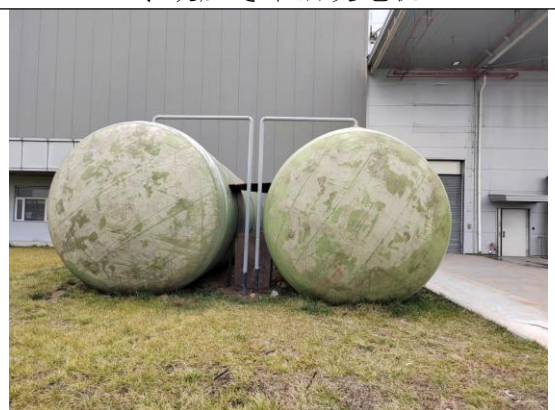
事故应急水罐（200m³）
