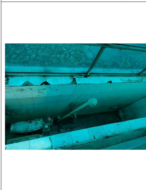
厂区废水总排口溢流堰
