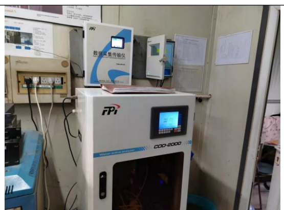
厂区废水总排口在线监测设施
