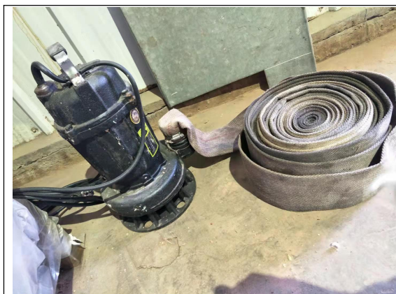
抽水泵和软管
