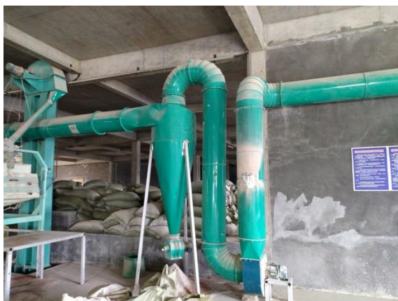
破碎车间除尘设施
