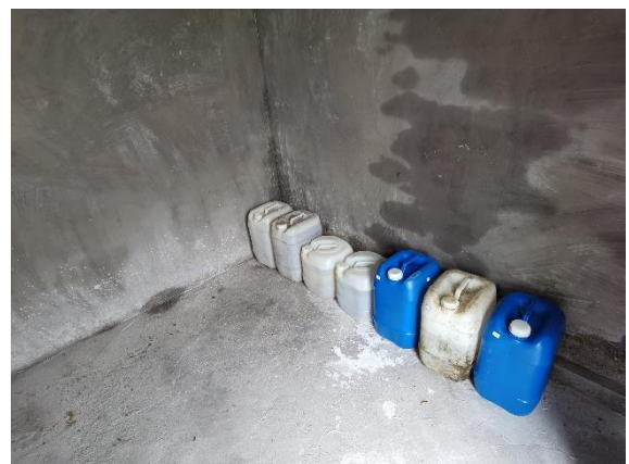
危险废物暂存间
