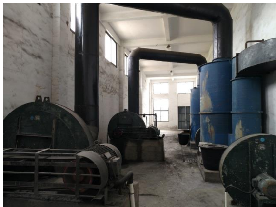
锅炉废气处理设施
