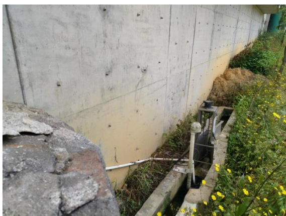
处理后废水排放口
