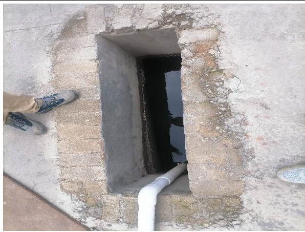
地面冲洗收集池
