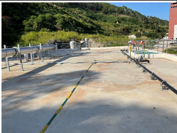
污水处理站事故应急池
