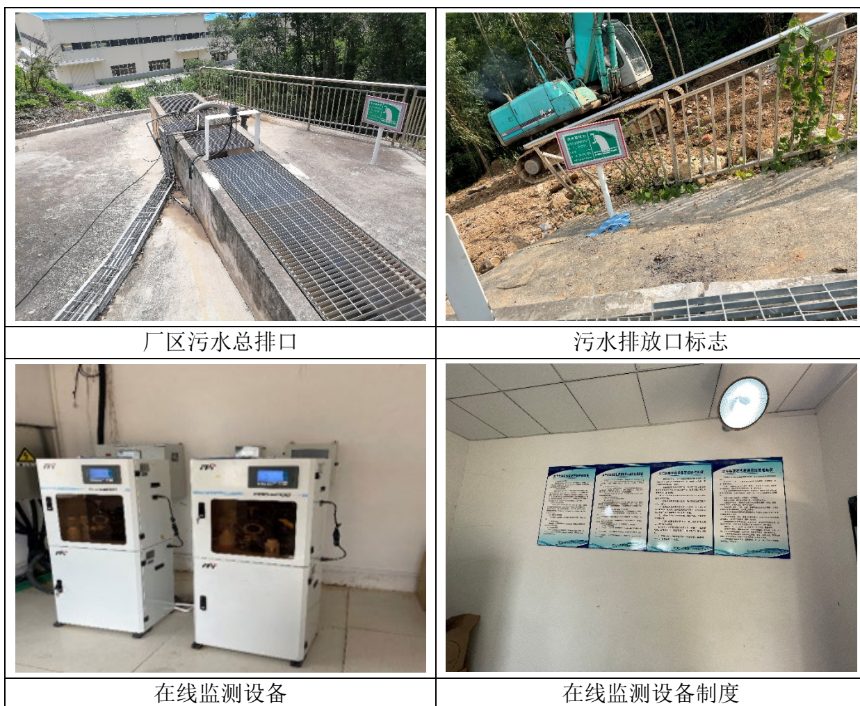
图 4-3 废水污染防治措施照片
