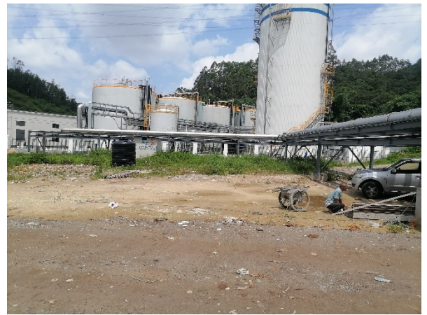
二期污水处理站
