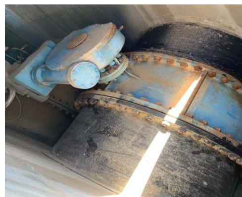
雨水排放设置阀门切换设施
