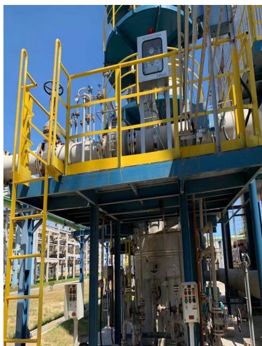
在线监控装置
