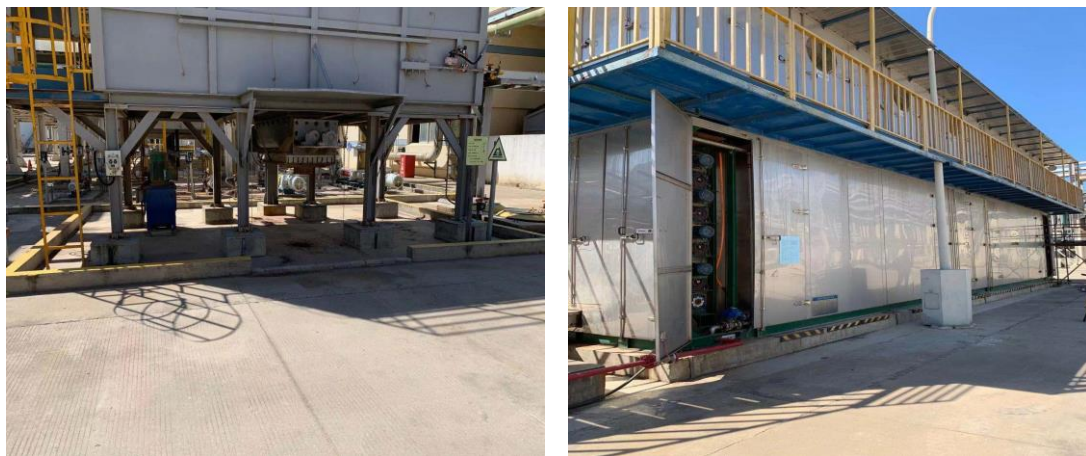
图 5.2-2 污泥产生与贮存情况
