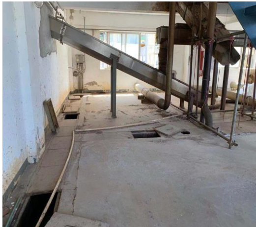
地面冲洗水收集系统
