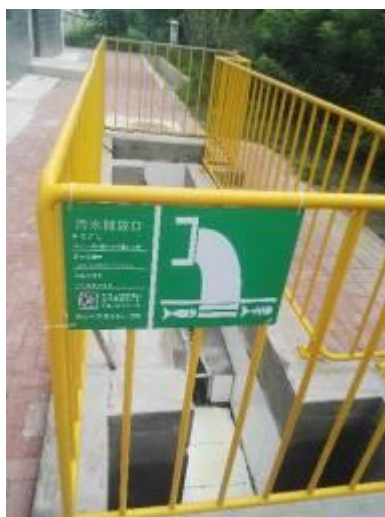
废水总排放口及标识牌
