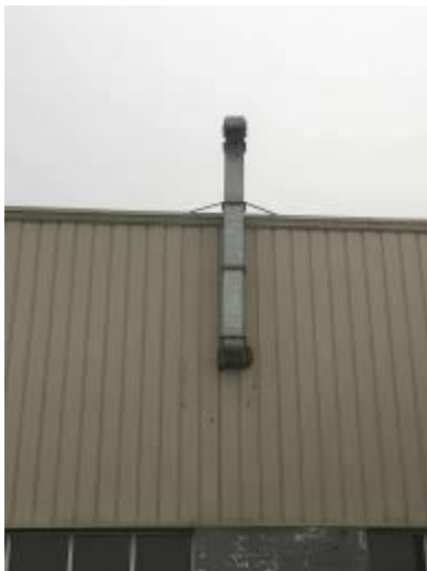
原有 1.2T 废气排气筒 DA006
