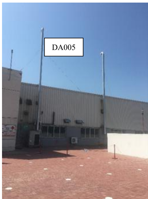
全厂热磨废气排气筒 DA005
