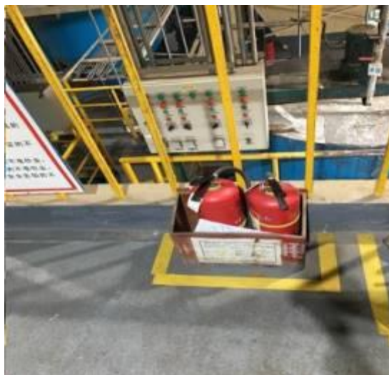
生产车间灭火器
