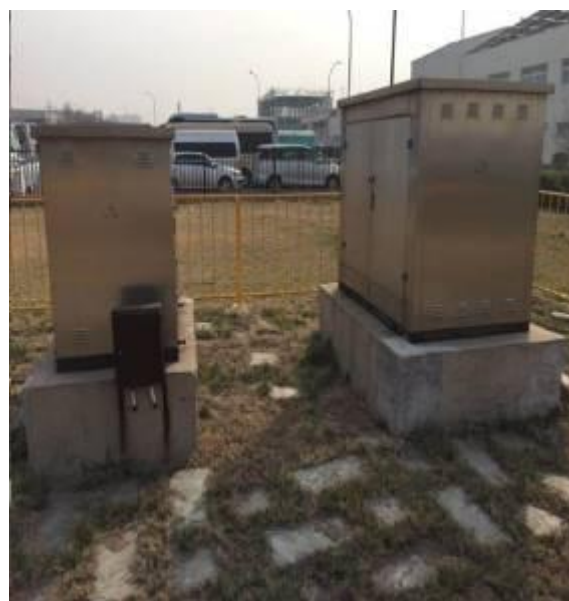
天然气调压柜
