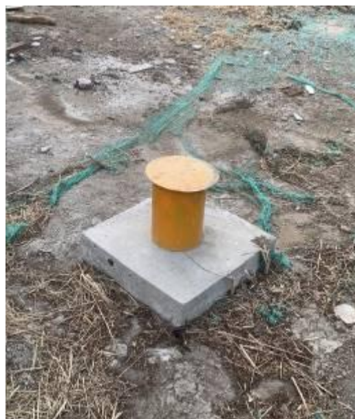
地下水监测井
