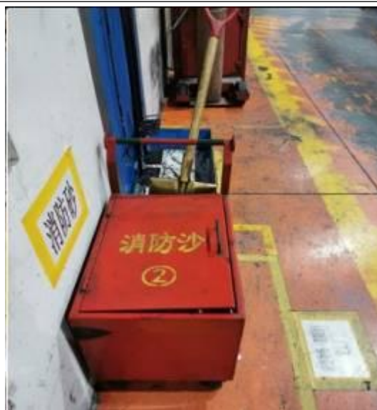
生产车间消防砂箱
