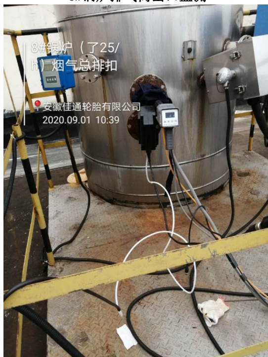
8#锅炉排气筒出口监测
