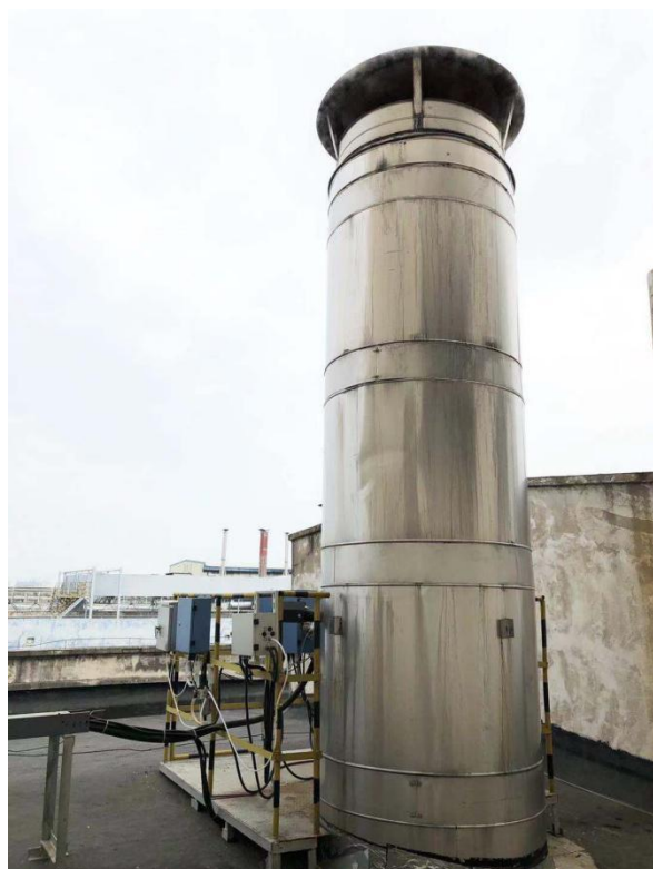
8#锅炉排气筒（高度：22 米）
