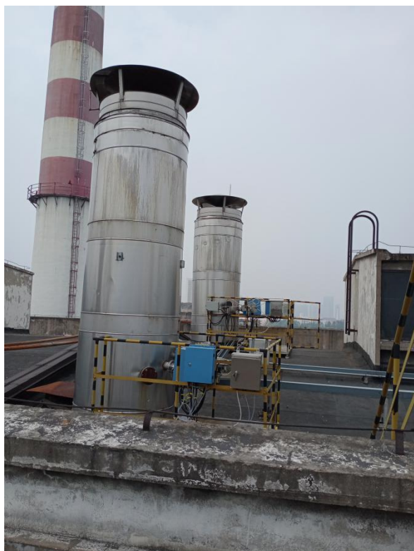
6#、7#锅炉排气筒（高度：32 米）
