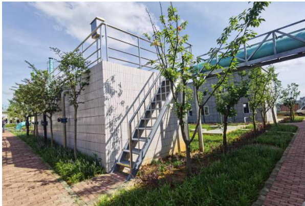
污泥提升泵房
