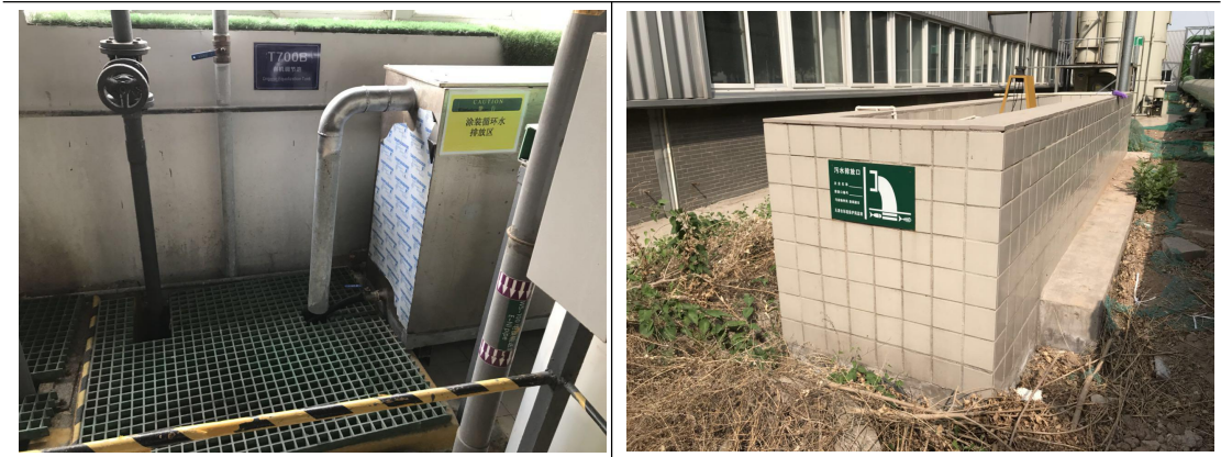
图 2 有机废水调节池 (喷漆循环水池排入污水站)
