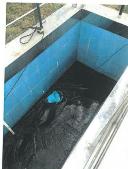
污水处理厂出口
