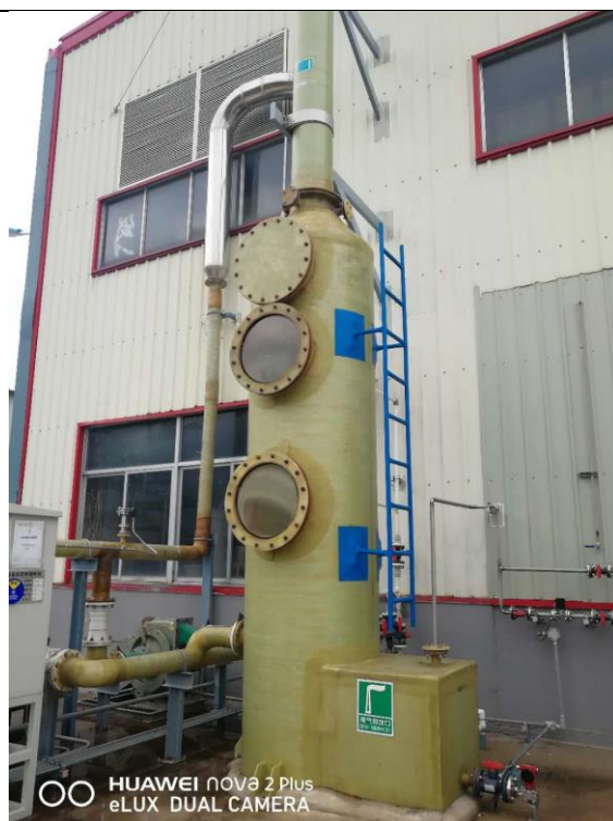
废气处理设施
