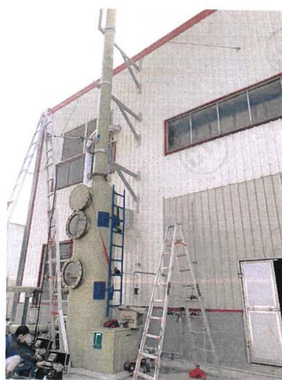
活性炭装置排气筒出口
