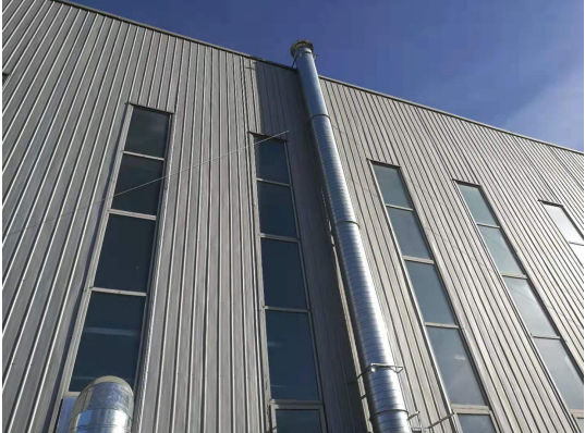
图 2.新建排气筒 17 米高排气筒 P 1
