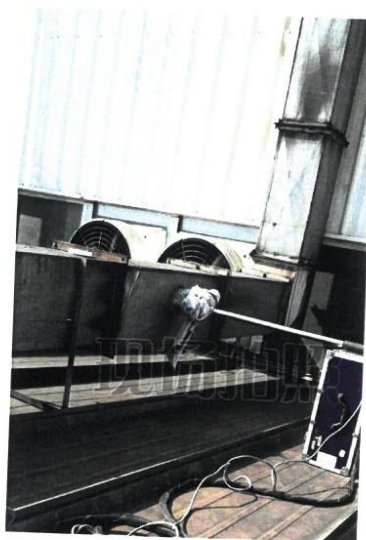
二线喷丸废气处理设施出口
