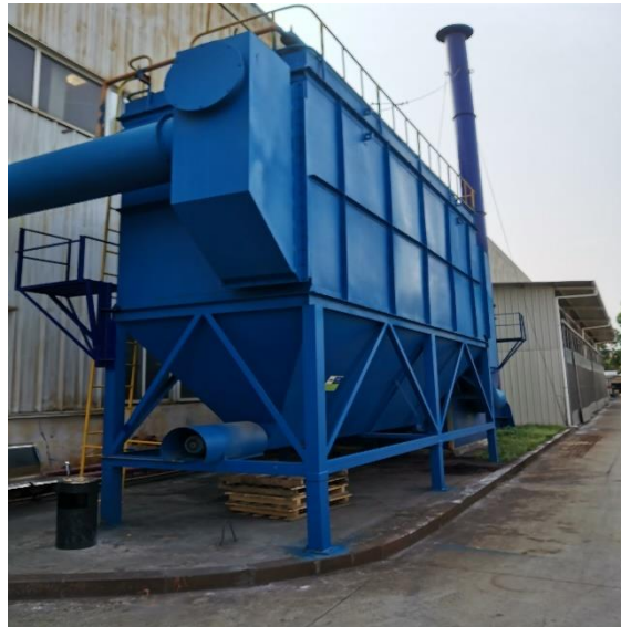
一线抛丸、喷丸除尘器
