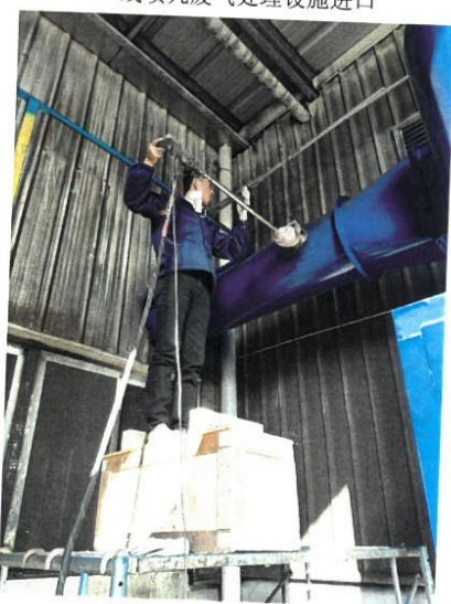
二线抛丸废气处理设施进口
