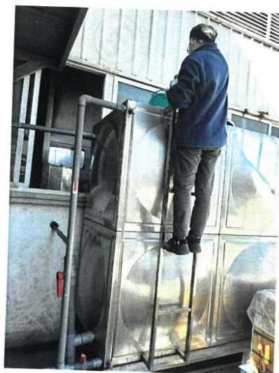
厂区污水站工业废水出口
