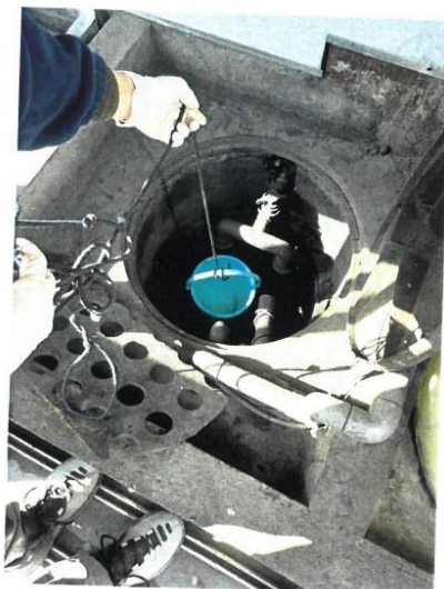
厂区污水站工业废水进口
