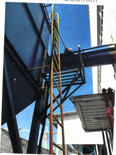
一线抛丸、喷丸废气处理设施进口
