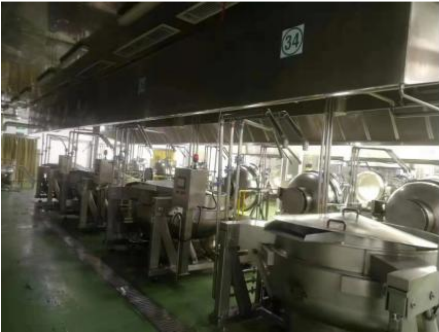
半固态酱汁调理品炒制工序 4 台 500L 燃气锅现场照片，对应排气筒 DA001(即环评中的 DA003)
