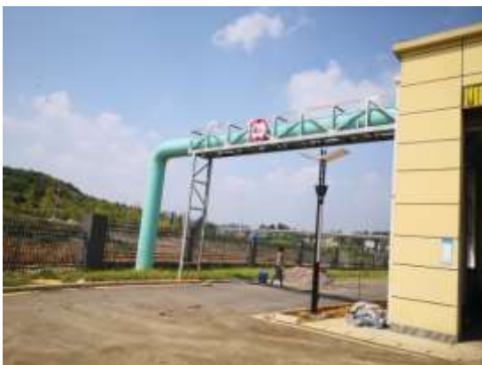
臭气收集管道
