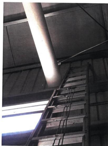
尾气处理设施出口
