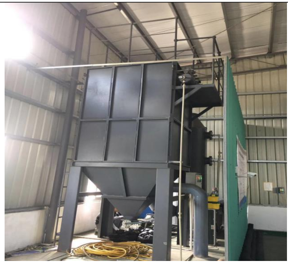
图 3-5 废气处理设施
