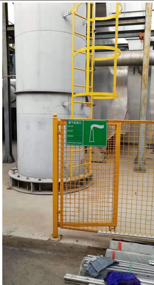
图 5 喷涂废气排气筒 P 1 *标识牌
