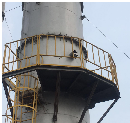
图 8 硫化废气排气筒 P 2 *采样 平台及采样监测口
