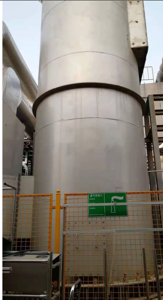
图 6 硫化废气排气筒 P 2 *标识牌
