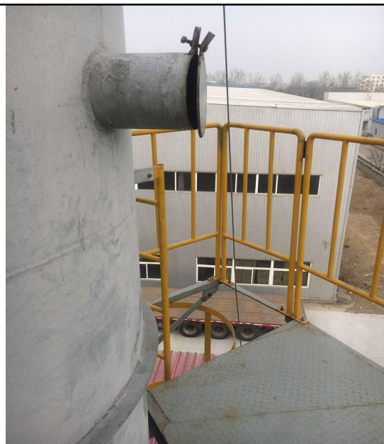
图 7 喷涂废气排气筒 P 1 *采样 平台及采样监测口
