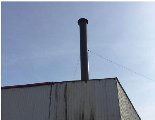
图 3 新建锅炉废气排气筒
