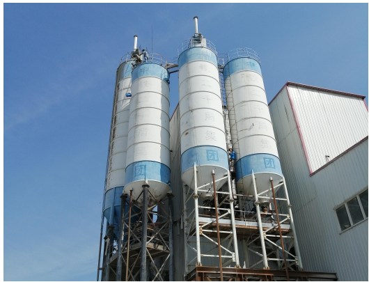
图 1 水泥粉料仓废气排放口 P 3-1 、P 3-2
