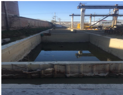
图10 砂石水洗、沉淀池
