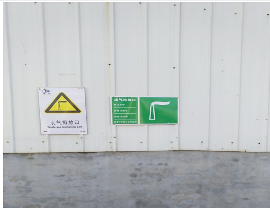
图 4 排气筒标识牌
