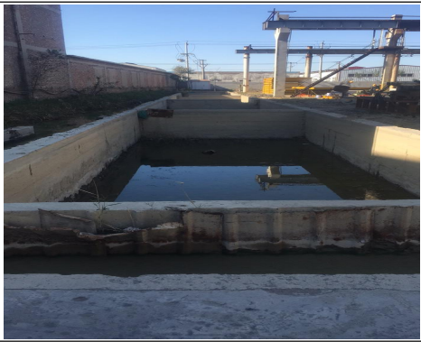
图2 砂石水洗、沉淀池
