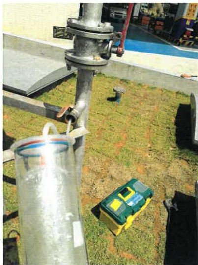
排气阀采样口
