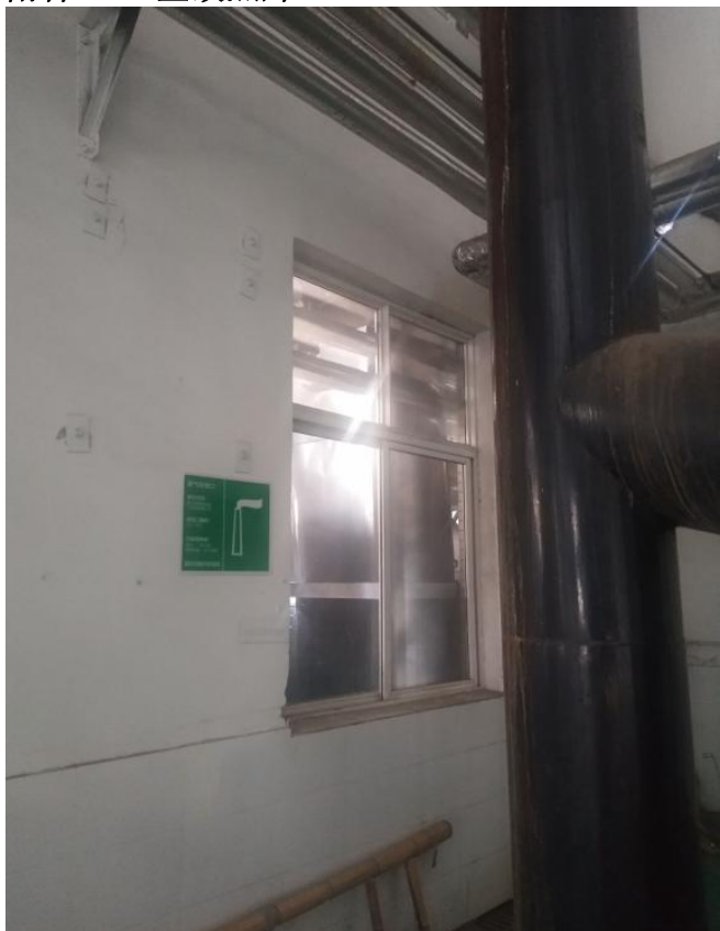
锅炉废气排放口标识
