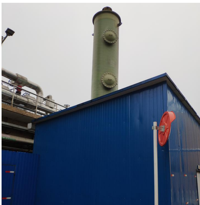
二期 10 米高碱液喷淋除臭塔
