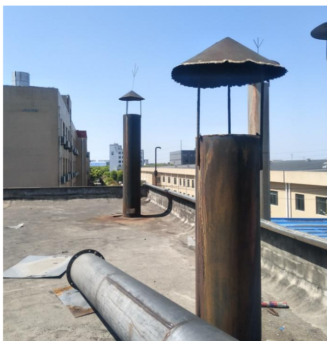
一期原有天然气锅炉排气筒
