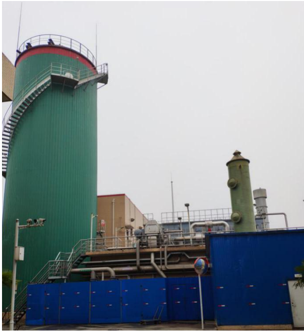
项目污水处理站
