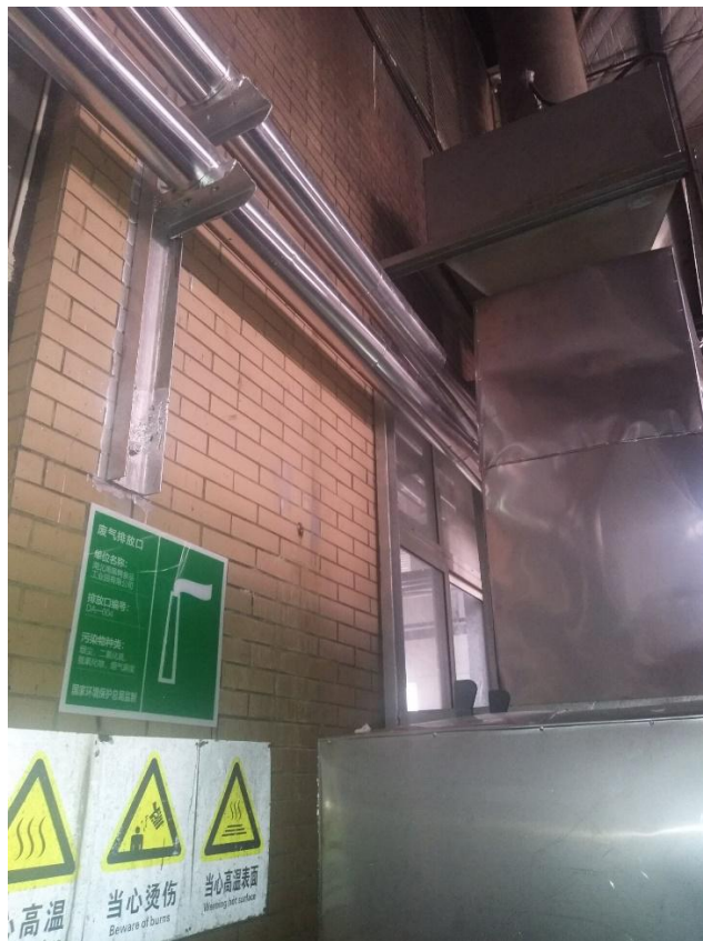
锅炉废气排放口标识
