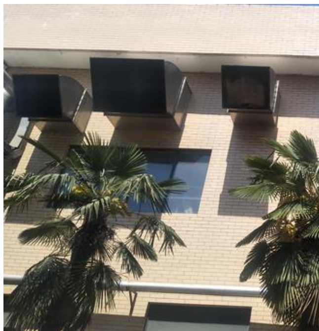
一期原有车间机械排风
