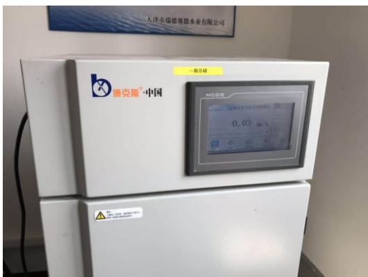
图15 一期总磷在线监测设备
