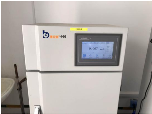
图11 二期总磷在线监测设备
