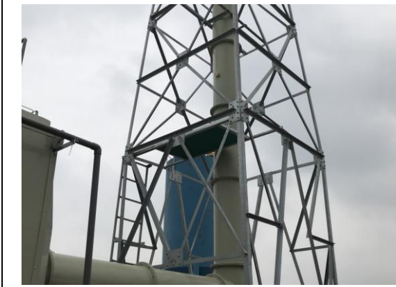
图7 1#除臭装置采样平台及采样口
