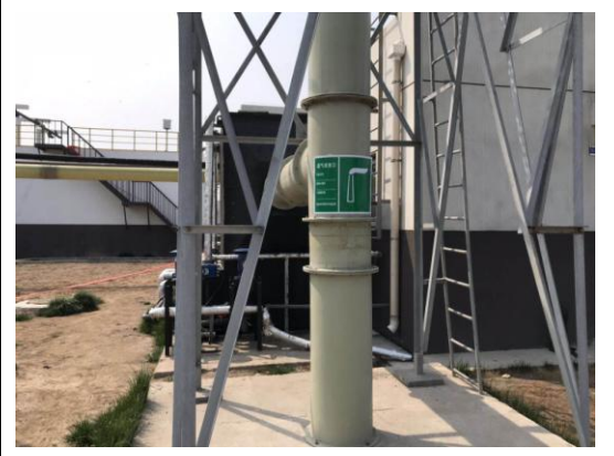
图8 1#除臭装置标识牌
