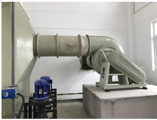
图 4 除臭装置风机减振基础
