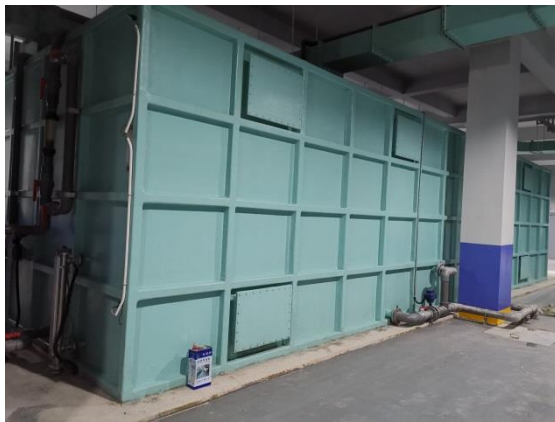
臭气处理装置
