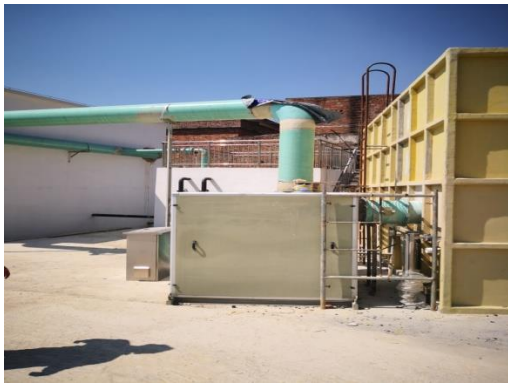
脱泥间风机隔音
