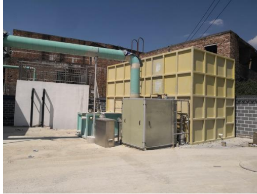
污泥间臭气处理装置
