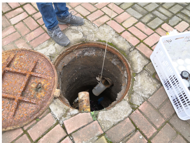
图 6.1-1 废水处理设施排放口采样
