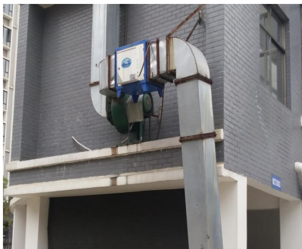
图 7.7-3 油烟排风管道及油烟净化器
