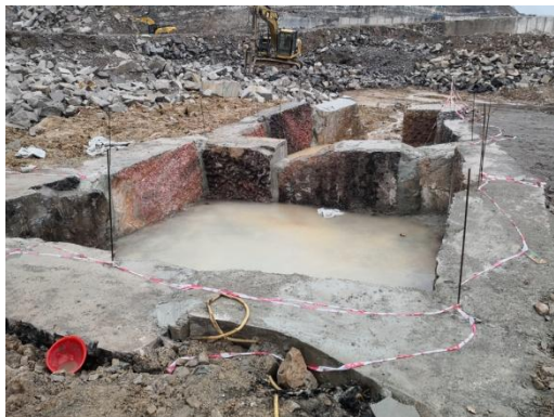
开采场区滴水水收集池（100m 3 ）
