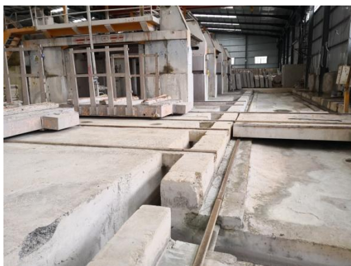
1#车间切割废水收集沟
