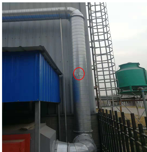
图7.有机废气处理设施进口
