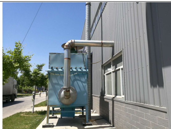
图4.喷砂工序除尘设施及排气筒P6
