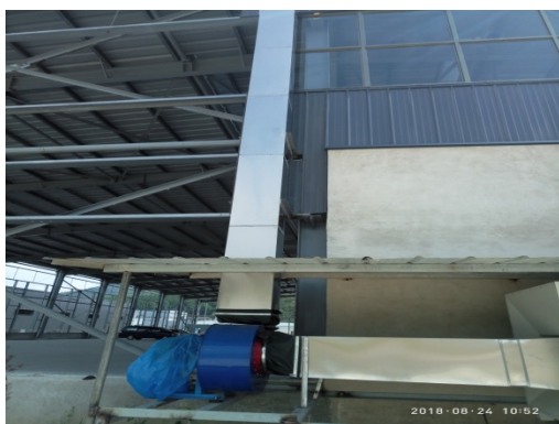
废气活性炭处理设施
