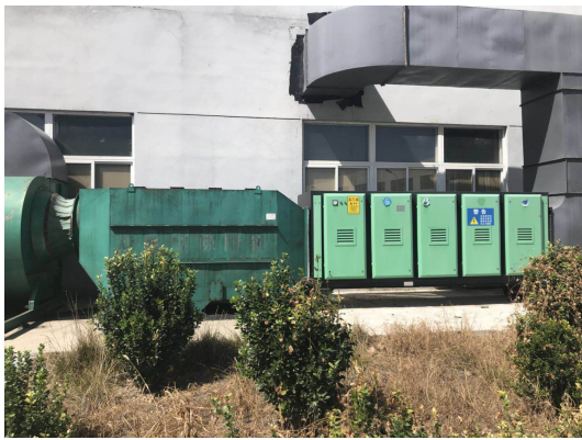
图 6 废气治理设施
