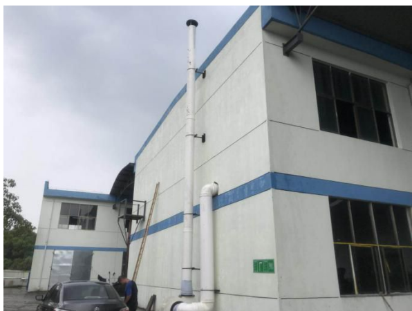
印花涂料车间研磨工序排气筒
