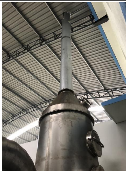
蒸汽间接加热干燥废气排气筒
