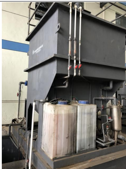
生产废水絮凝沉淀池
