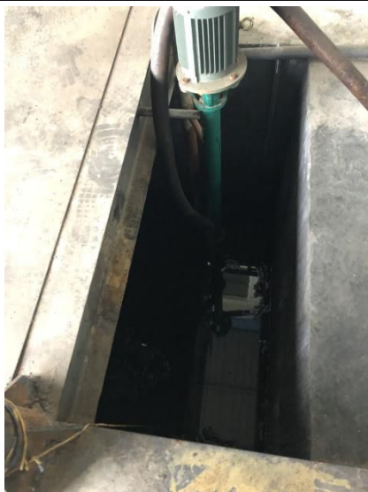
生产废水加药池
