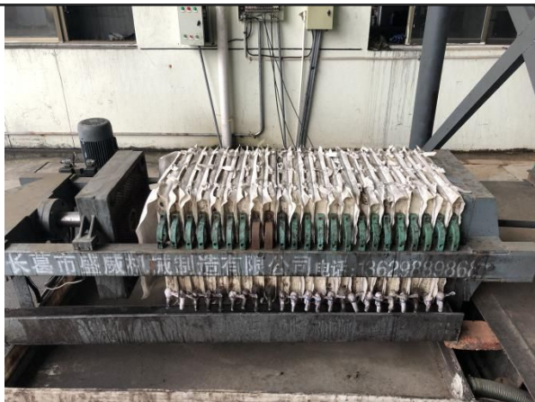
生产废水过滤装置
