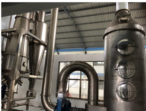
蒸汽间接加热干燥废气处理设施
