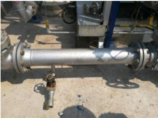
图3 油气回收处理设施进口浓度采样口
