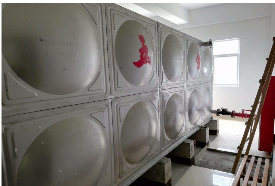
图 3.3-8 高位消防水箱
