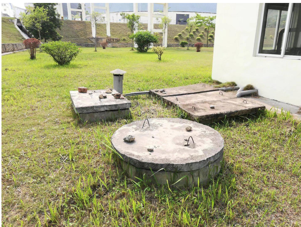
图 3.2-3 依托项目污水处理站
