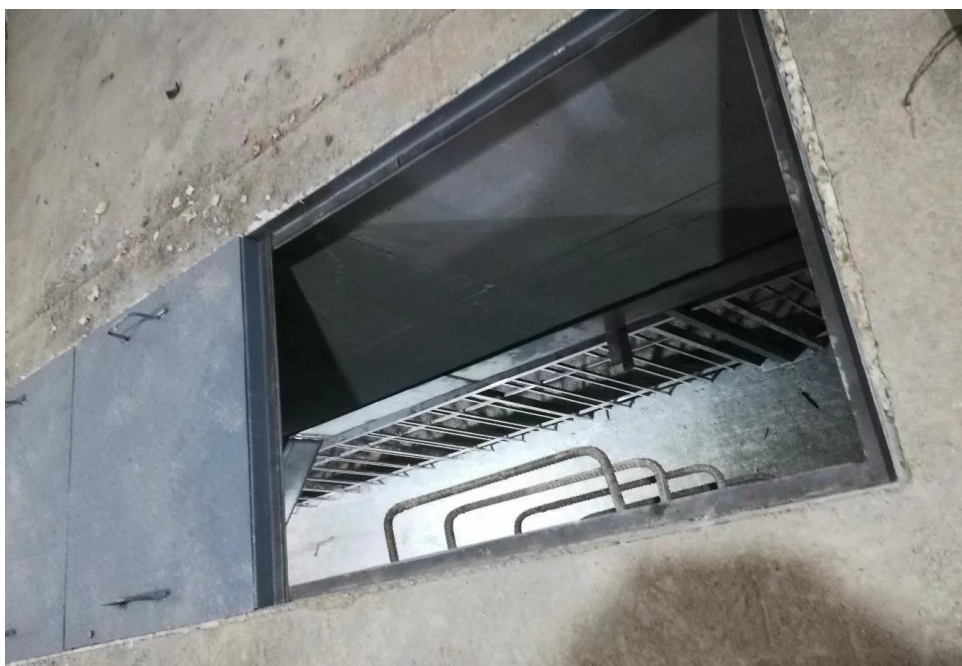
图 4.2-2 渗滤液事故应急池
