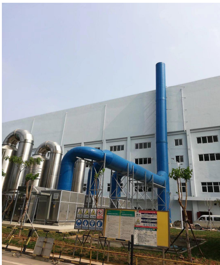
图 4.1-12 除臭装置设施及排放口
