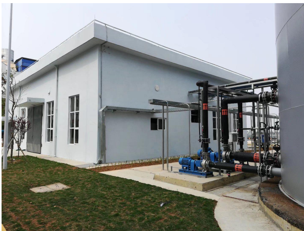
图 3.3-4 渗滤液处理车间
