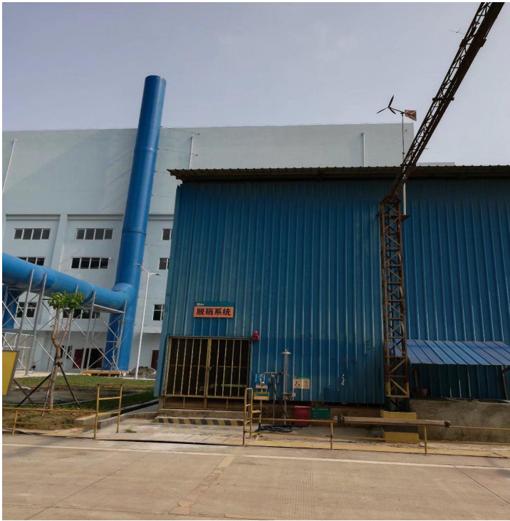
图 4.2-1 氨水储存区域现场图
