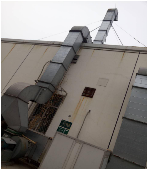
图 2：废气排气筒照片
