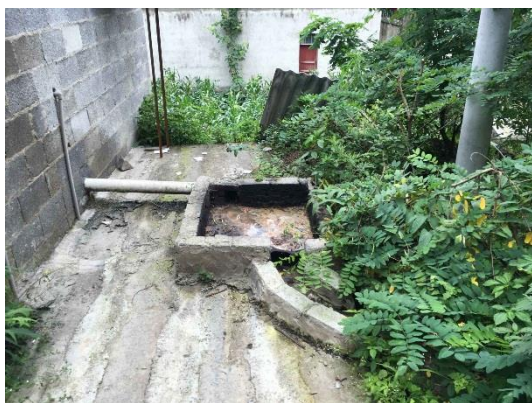
食堂废水隔油池
