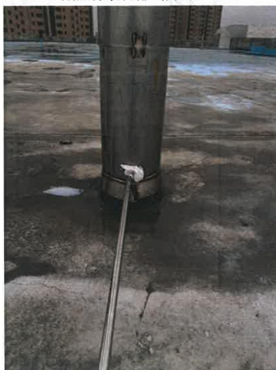
一期加弹项目排气筒出口 14#
