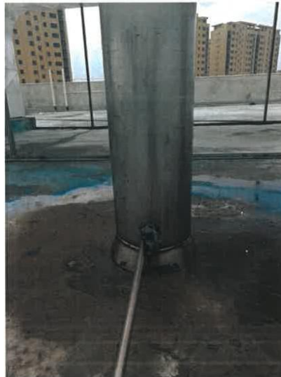
一期加弹项目排气筒出口 9#
