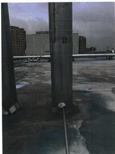
一期加弹项目排气筒出口 6#
