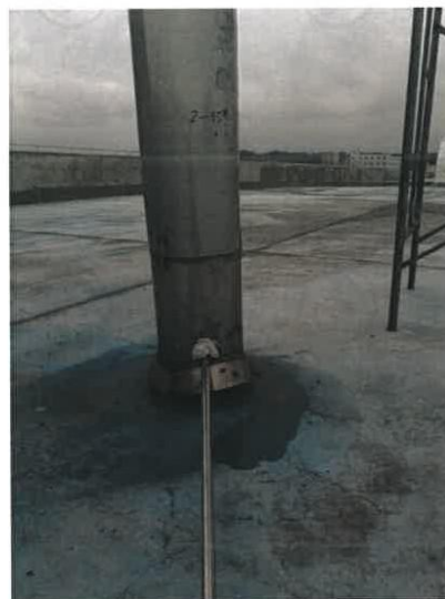
二期加弹项目排气筒出口 35#
