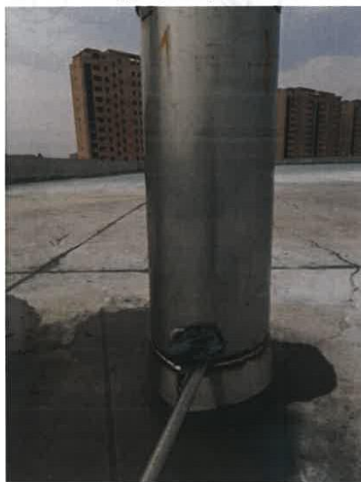
一期加弹项目排气筒出口 18#
