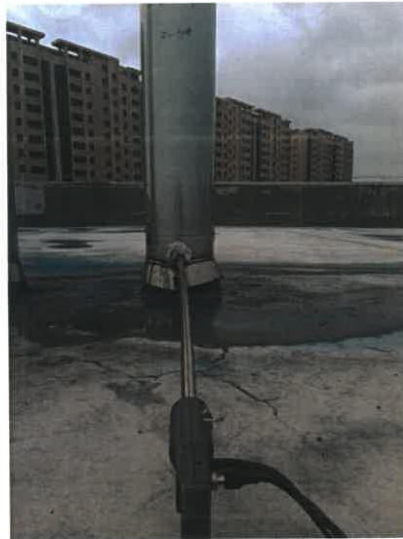
二期加弹项目排气筒出口 31#
