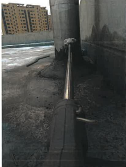
一期加弹项目排气筒出口 1#
