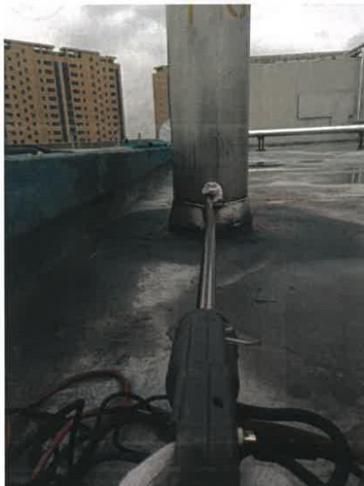
一期加弹项目排气筒出口 8#
