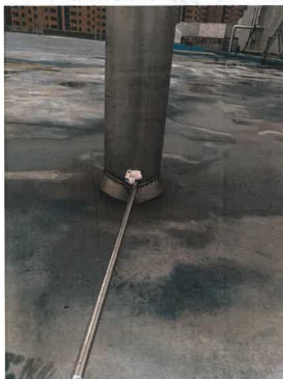
一期加弹项目排气筒出口 10#
