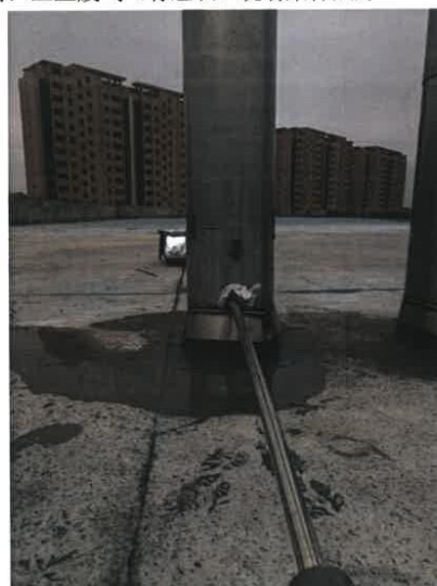
二期加弹项目排气筒出口 36#
