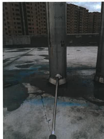
一期加弹项目排气筒出口 15#
