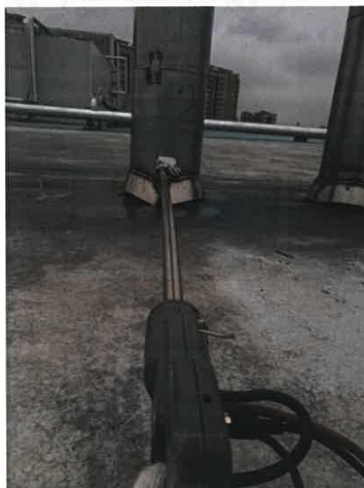
二期加弹项目排气筒出口 26#
