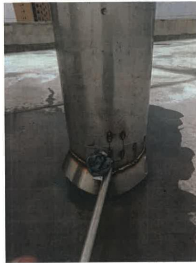
二期加弹项目排气筒出口 33#
