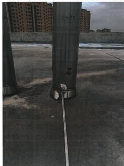
二期加弹项目排气筒出口 19#
