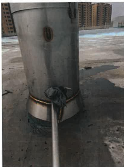
二期加弹项目排气筒出口 32#
