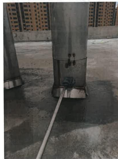
二期加弹项目排气筒出口 23#
