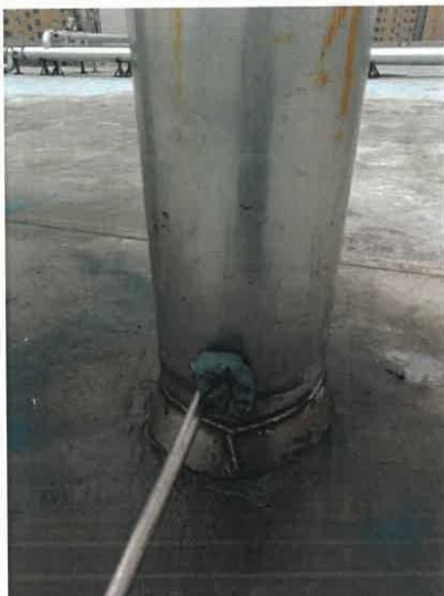
一期加弹项目排气筒出口 4#
