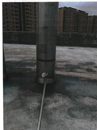
二期加弹项目排气筒出口 29B#
