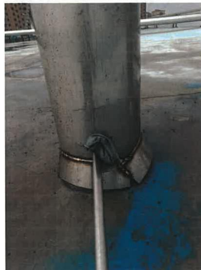
二期加弹项目排气筒出口 27#
