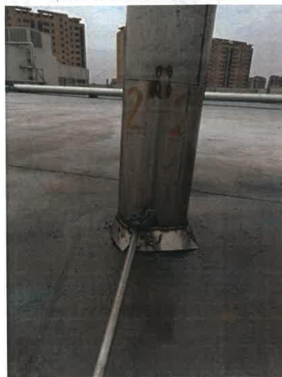
二期加弹项目排气筒出口 22#
