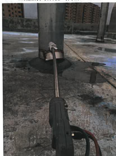
二期加弹项目排气筒出口 29A#
