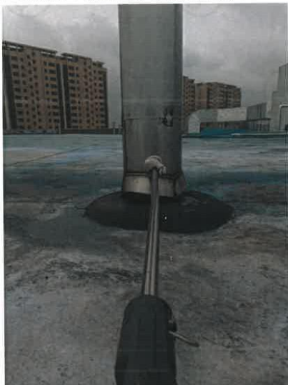
二期加弹项目排气筒出口 28A#
