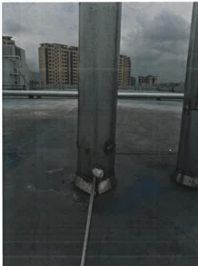
二期加弹项目排气筒出口 24#
