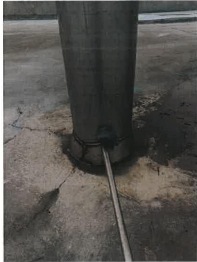
一期加弹项目排气筒出口 3#
