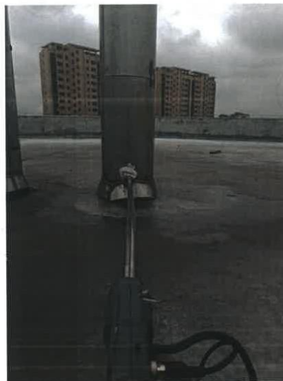
二期加弹项目排气筒出口 21#
