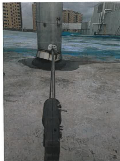
二期加弹项目排气筒出口 28B#
