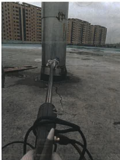
一期加弹项目排气筒出口 16#
