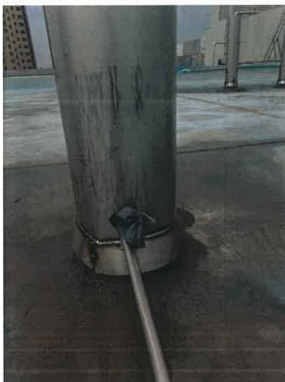
一期加弹项目排气筒出口 12#
