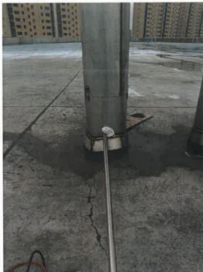
二期加弹项目排气筒出口 34#
