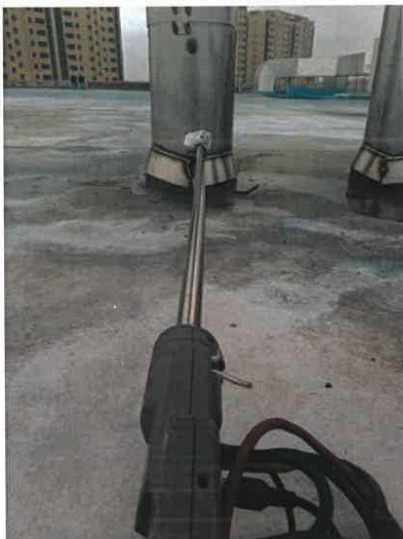
二期加弹项目排气筒出口 30#
