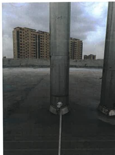
一期加弹项目排气筒出口 5#
