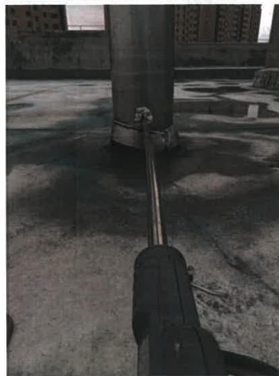
一期加弹项目排气筒出口 11#
