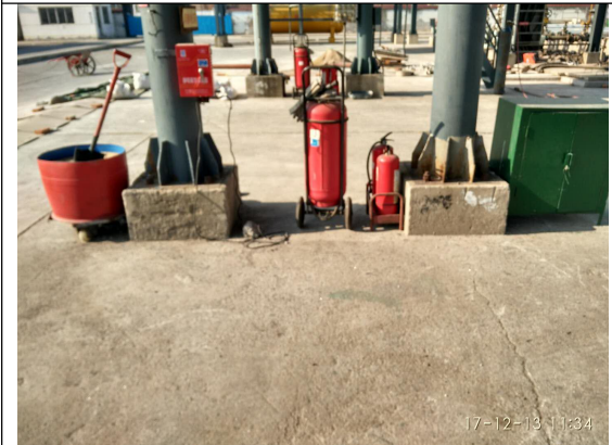
图 3 罐区及装卸区消防物资
