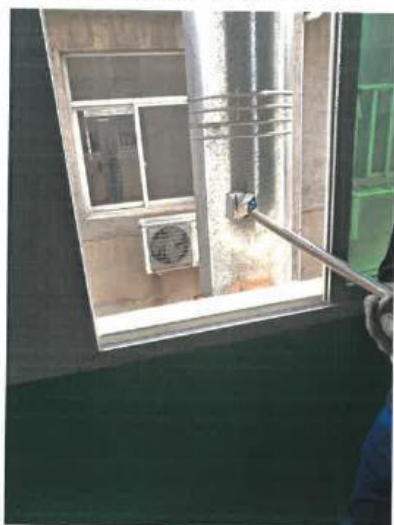
压铸车间废气排气筒出口
