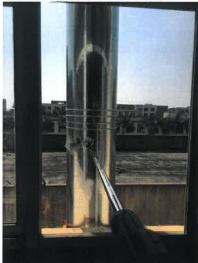
注塑废气排气筒出口
