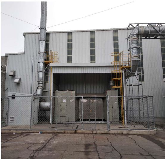
图 1 废气处理设施
