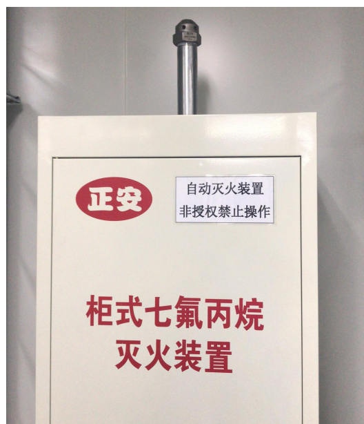
图 2：生产车间柜式七氟丙烷灭火装置
