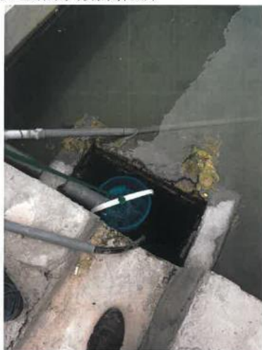
生活污水出口
