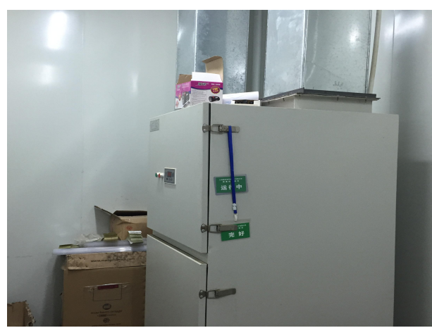
车间布袋除尘装置
