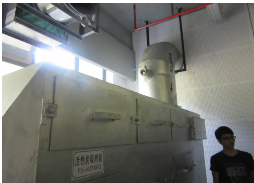
图 16 有机废气处理设施
