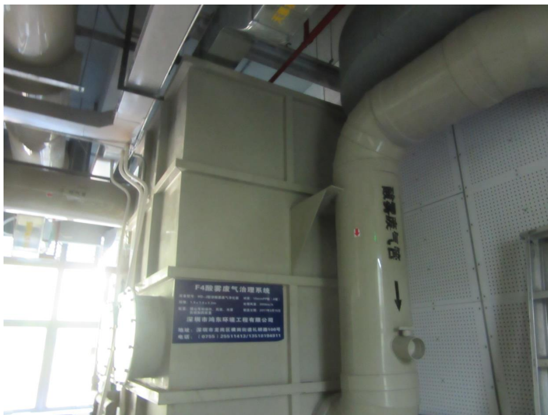
酸性废气处理设施
