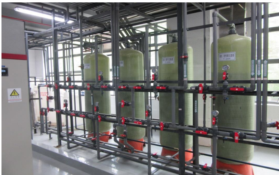
图 18 生产废水处理设施
