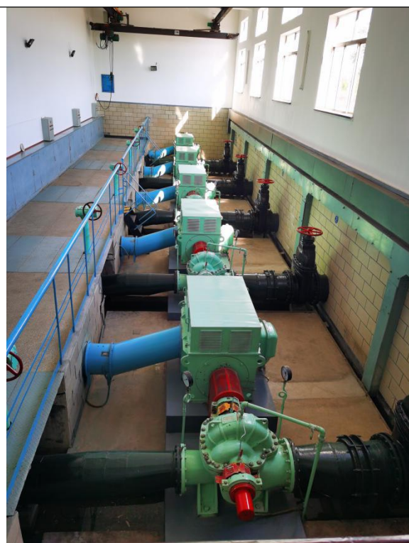
送水泵房一卧式离心泵
