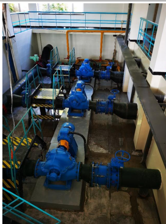
送水泵房二卧式离心泵
