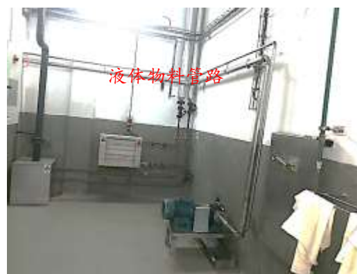
液体物料转移管路
