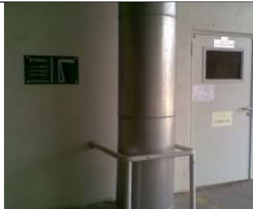
锅炉排气标识牌 2
