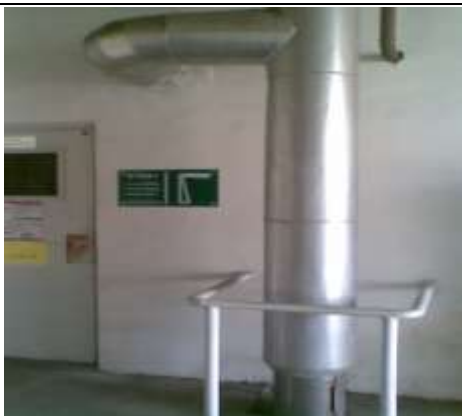
锅炉排气标识牌 1
